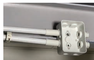
Conduits et boîtier électrique sur poutre acier
