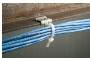
Câbles sur poutre acier
