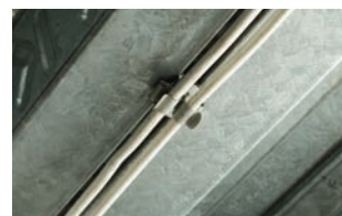
Câbles et conduits sur bac acier
