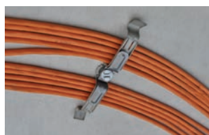
Câbles sur plafond / mur en béton
