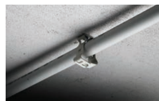
Conduit sur dalle béton
